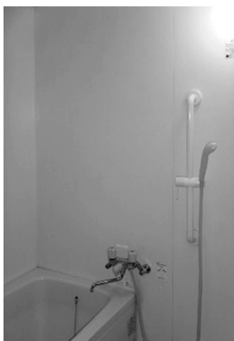
風呂設備 (給湯器が導入されています)
