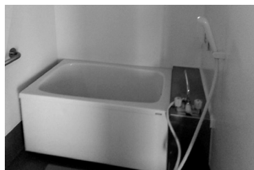
風呂設備 (給湯器が導入されています)
